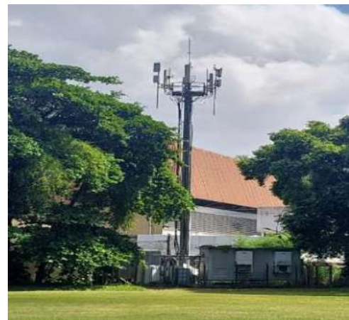
Antena de telefonia da empresa Telefônica (Vivo), localizada ao lado do campo de futebol e próximo ao muro que divide o campo da rua.
